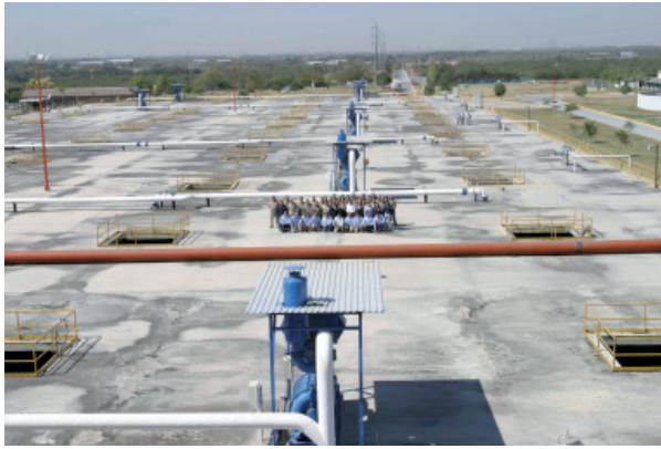
Vista de área de reactores en la planta de tratamientos de aguas negras en Dulces Nombres, N.L., México.
